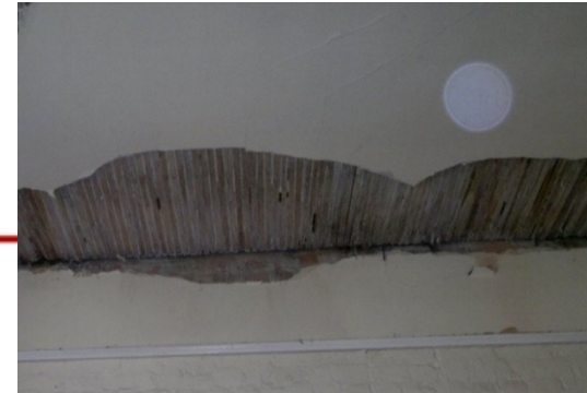
Odlamanje žbuke zbog interakcije zid – strop / prijenos posmika
